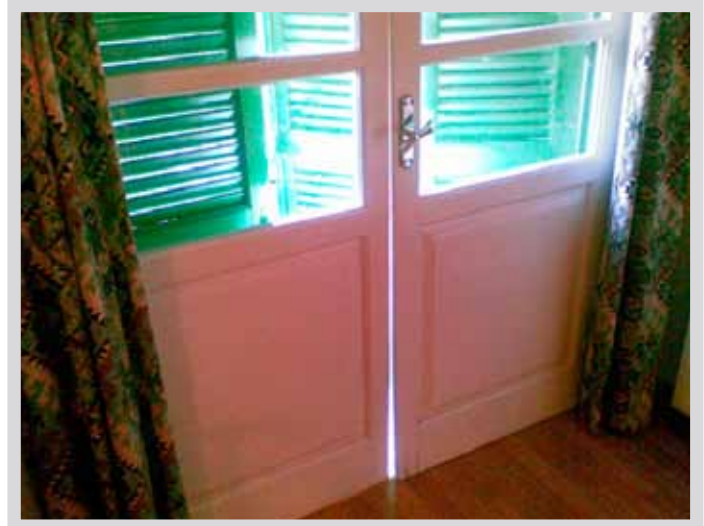
Κλειστή πόρτα σε κυπριακό ξενοδοχείο όλο χαραμάδες αλλά με διπλά γυαλιά και κατασκευασμένη με ακατάλληλο ξύλο
